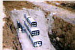
地区内の電線類を地中に。景観に配慮するとともに耐震性が高い。
