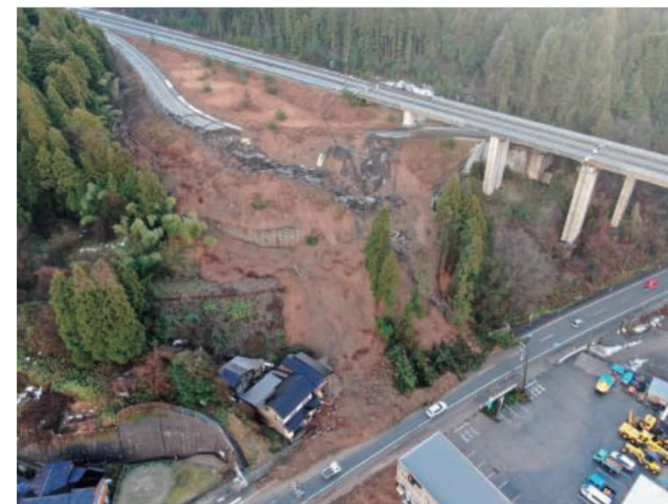
盛土部が崩落した能越自動車道（穴水町） 出典：国土交通省
