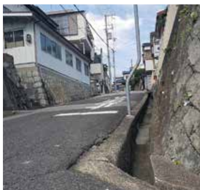
▶ 溝蓋のない側溝
