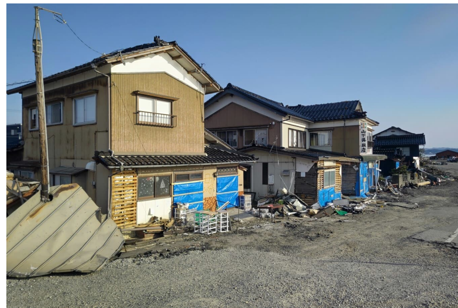
珠洲市宝立町鵜飼地区の津波被害
