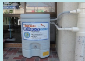
庁舎等に設置した雨水タンク
