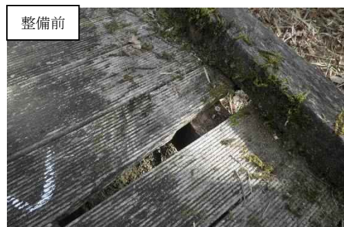
老朽化した園路
