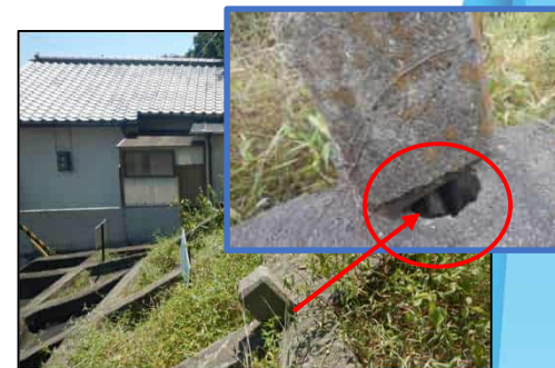
【アンカー頭部浮き状況 明神町】
