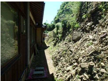
②斜面状況(人家裏)
