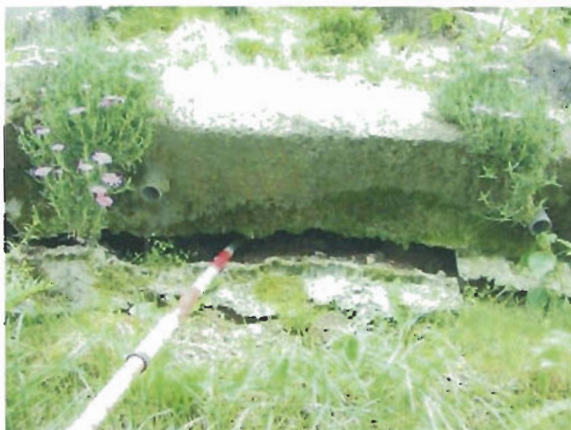
法枠工の下面では、中詰めモルタルの中抜けにより、空洞が生じている。
