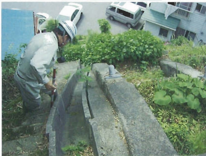
地山の変動に伴い、法面の縦水路が変形し、隙間が拡大している。
