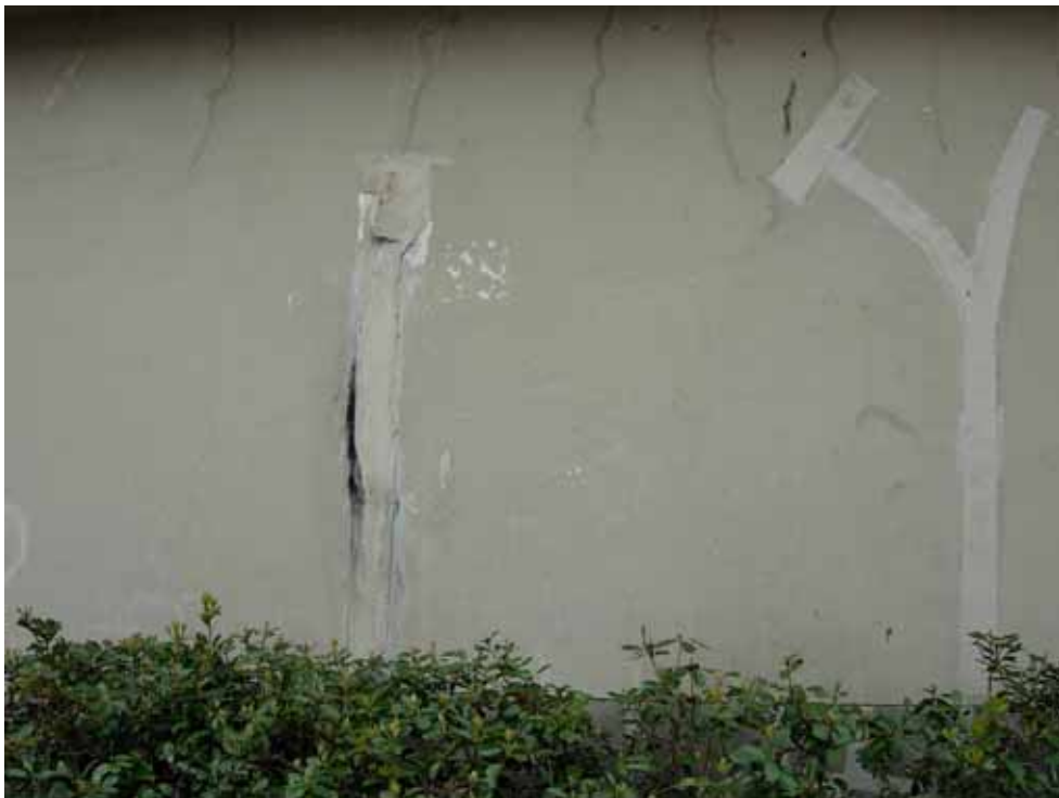
西宮浜松原鉄筋団地現状写真 外部：外壁クラック
