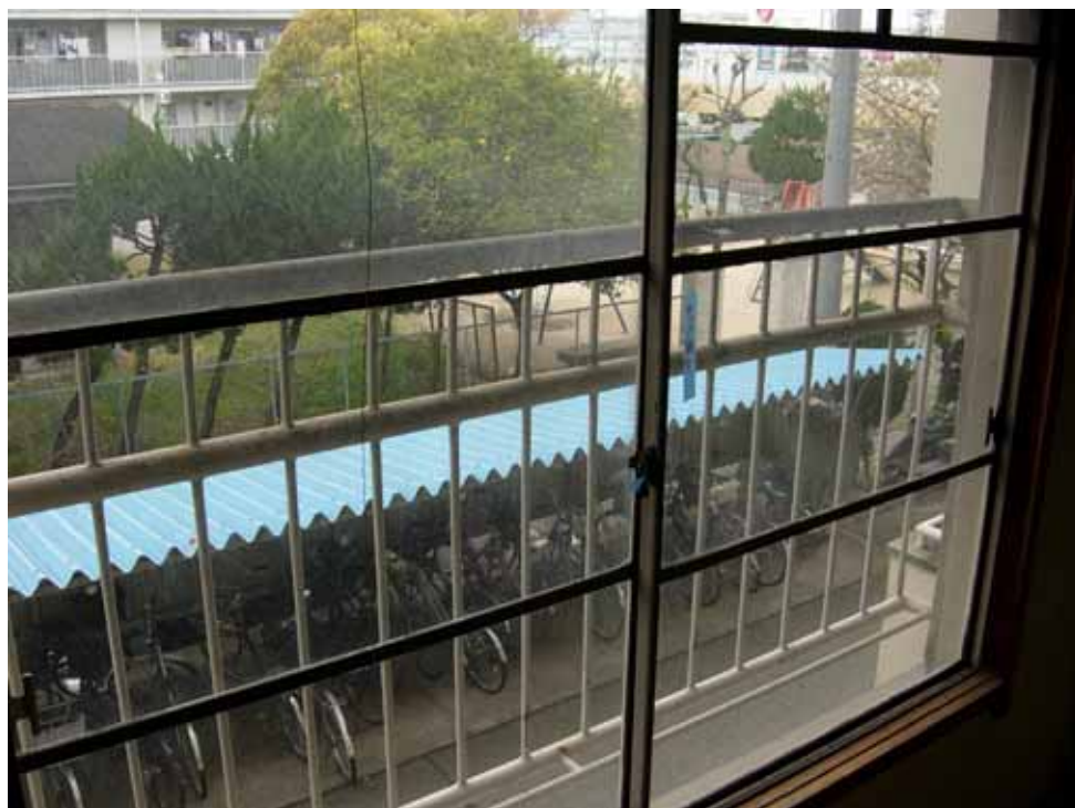
西宮浜松原鉄筋団地現状写真 内部：スチールサッシ（たわみにより開閉困難）
