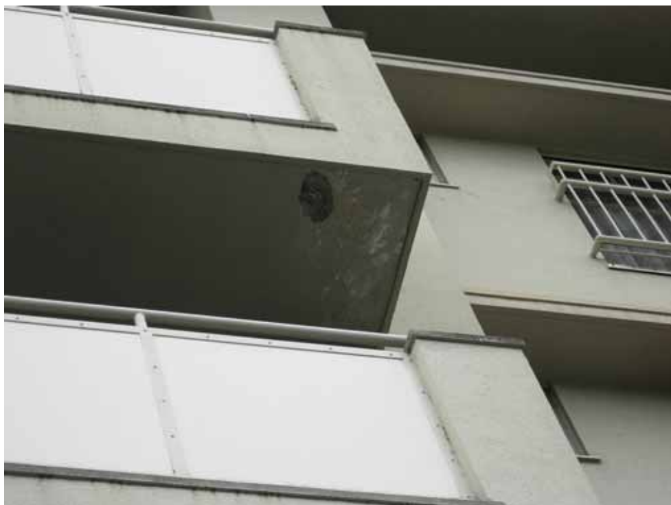
西宮浜松原鉄筋団地現状写真 外部：コンクリート剥離
