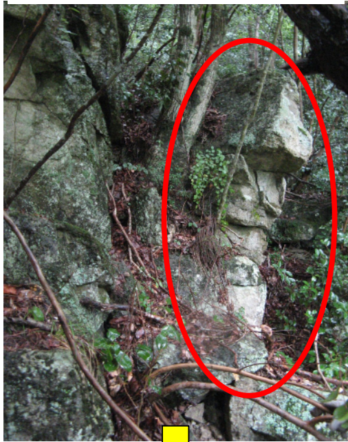
【亀裂の多い不安定な岩盤】
