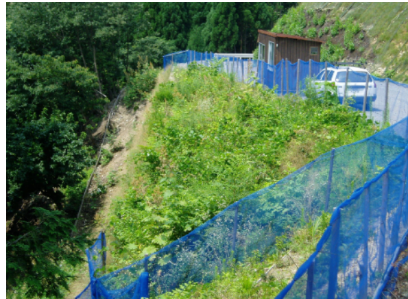
林道工事現場から採取した現地植生の種子 を含む表土を利用した緑化工
