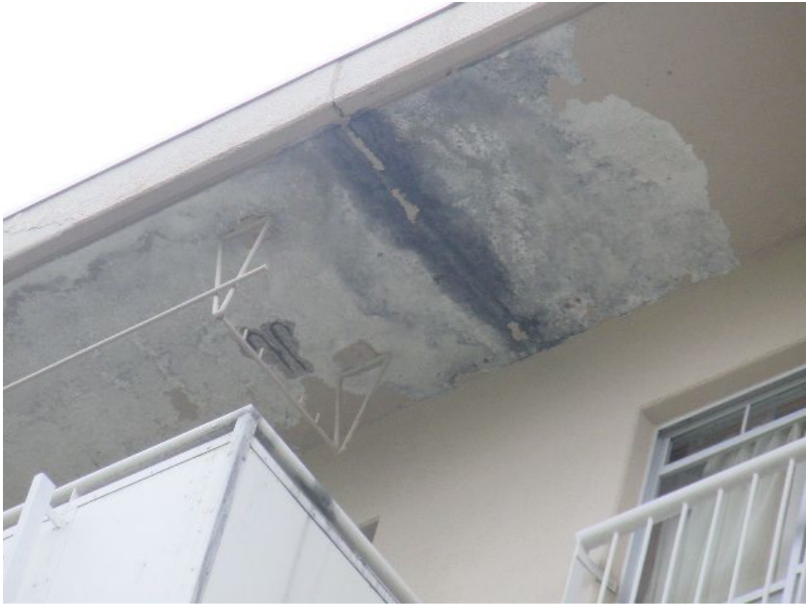
姫路御着住宅現状写真 外部：軒裏部分のコンクリート劣化状況
