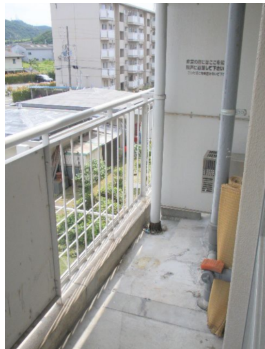
姫路御着住宅現状写真 手狭で防災上不安全なバルコニー
