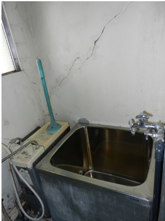
宝塚山本住宅現状写真 内部：手狭で老朽化した浴室・浴槽 （壁にクラック）
