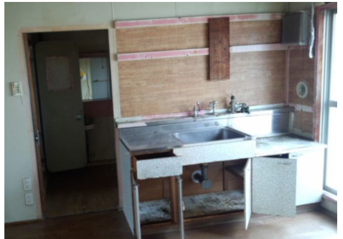
宝塚山本住宅現状写真 内部：手狭で老朽化した台所
