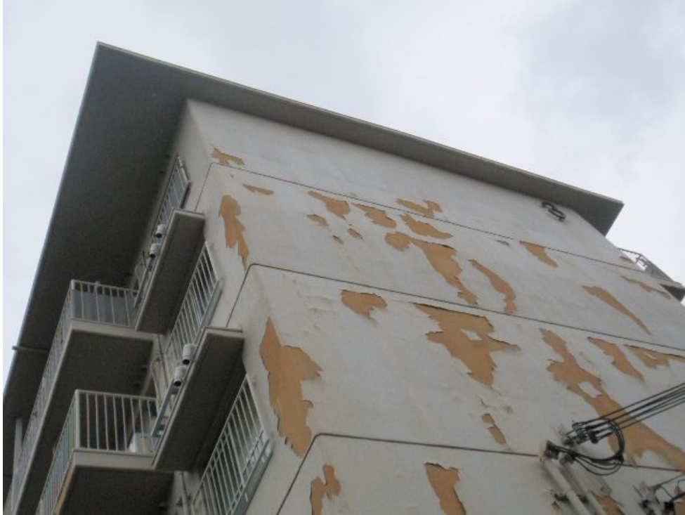
宝塚山本住宅現状写真 外部：外壁部分の劣化状況
