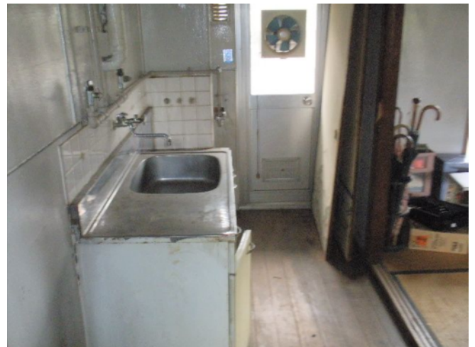
中村住宅現状写真 手狭で老朽化した台所
