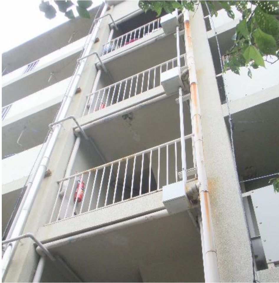
中村住宅現状写真 外観 3：階段室部分のコンクリート劣化状況
