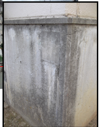
基礎コンクリートの割れ
