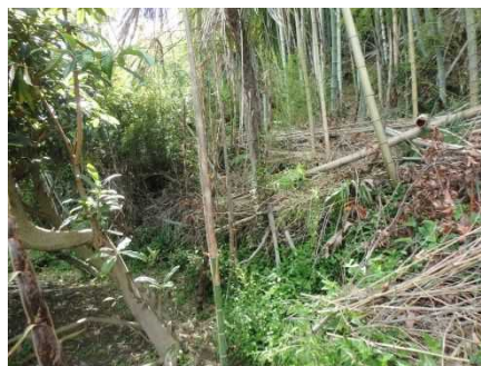
③斜面の荒廃状況
