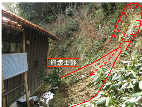
③がけの荒廃状況(斜面崩壊)
