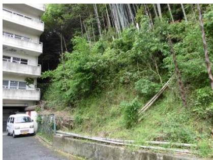
②斜面状況(人家裏)
