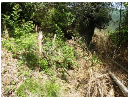
②斜面状況(人家裏)
