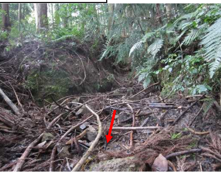
溪流荒廃状況
