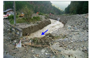
土砂埋塞状況
