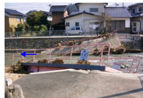
橋梁流失状況
