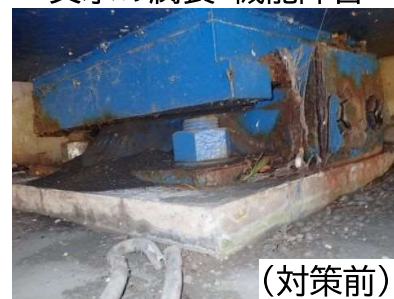
支承の腐食・機能障害
