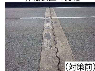
伸縮装置の劣化
