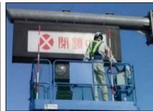
ETC車線表示板点検
