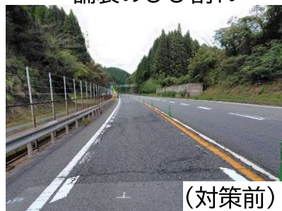
舗装のひび割れ
