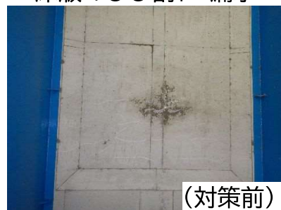
床版のひび割れ・漏水
