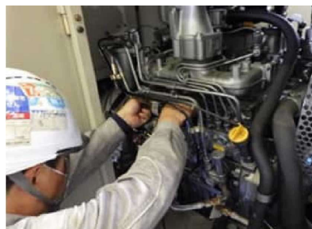
自家発設備保守・点検
