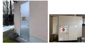
無停電化（非常用発電装置） 浄化槽機器の予備電源 出力43kVA連続運転時間15.2時間
