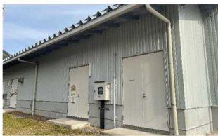
無停電化（非常用発電装置） 道の駅施設の予備電源 出力75kVA連続運転時間100時間
