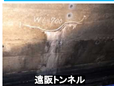
【ひび割れ・漏水】
