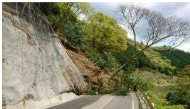
道路区域上部の民有地の崩壊（H29.4 養父市）
