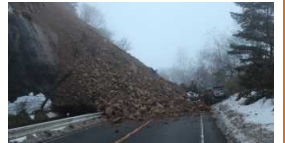
対策済箇所の崩壊
