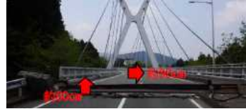
路面に生じた段差（熊本地震）
