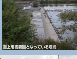
遡上阻害要因となっている堰
