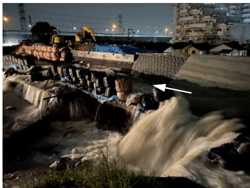
写真-3.2 天神川破堤直後(5/8 2:30)
