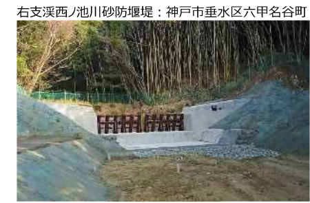
右支溪西ノ池川砂防堰堤：神戸市垂水区六甲名谷町 砂防堰堤の設置 (兵庫県 神戸土木事務所)
