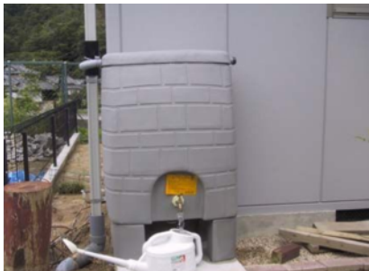
写真 2.2.10 雨水貯留タンク
