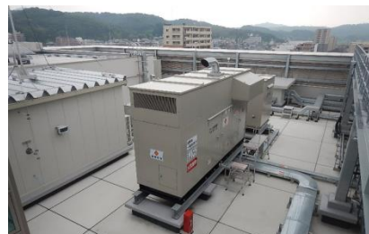
三田市新庁舎 屋上階発電設備
