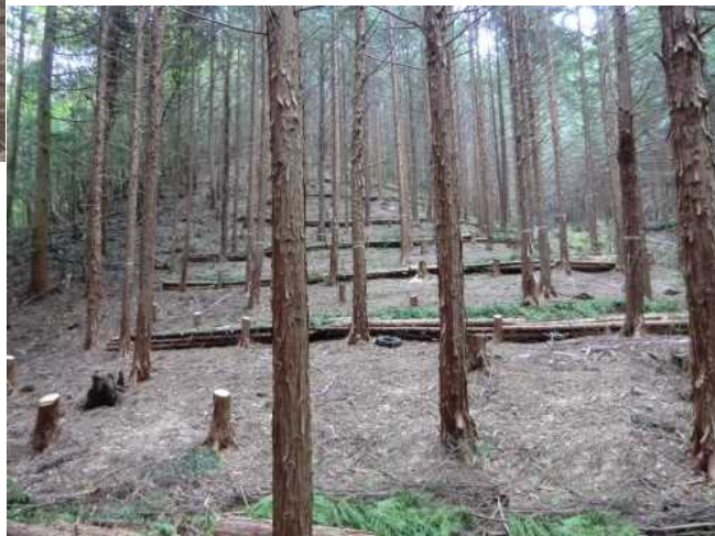
緊急防災林（斜面对策）
