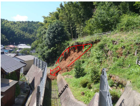
待ち受け擁壁が崩壊土砂を捕捉 (丹波市)
