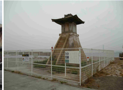
石積躯体と鉄筋コンクリート造の高さ 7.3m の灯籠。藩政時代から残る明石港のランドマーク
