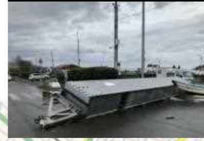
④陸閘損壊 3基
