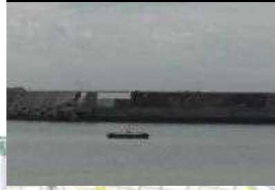
③防波堤損壊
