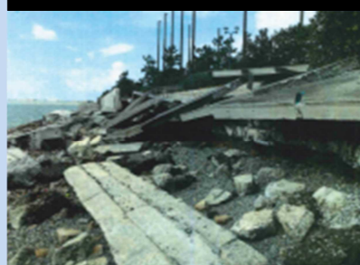
⑨防潮堤損壊 L=80m
