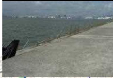
②防護柵倒壊 L=553m
