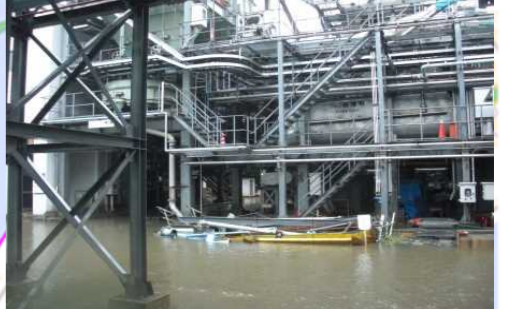
⑨浸水被害（鳴尾浜）
