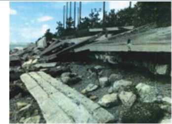
東側の防潮堤の被災状況
