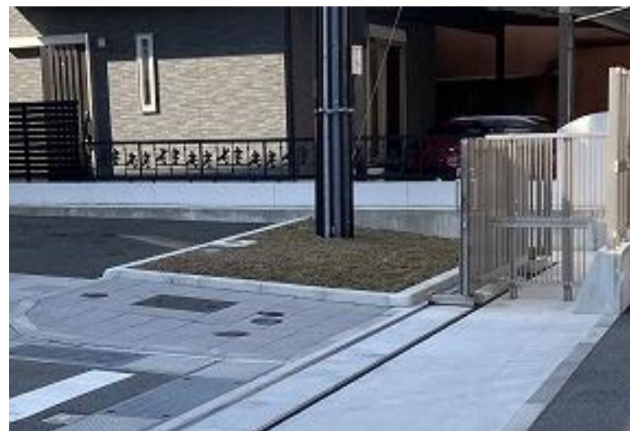
事務所 加古川市 不良
