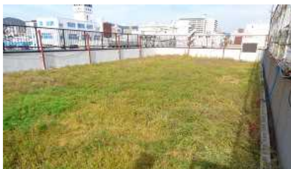
灌水装置の不良、植栽時の土壌不良
