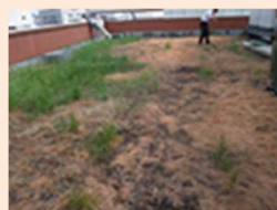
維持管理不足での枯損
