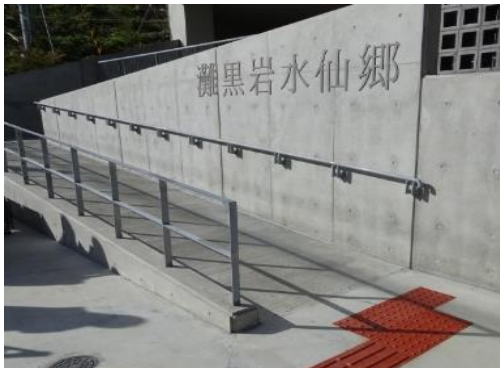
床面とコントラストのある点字ブロック
