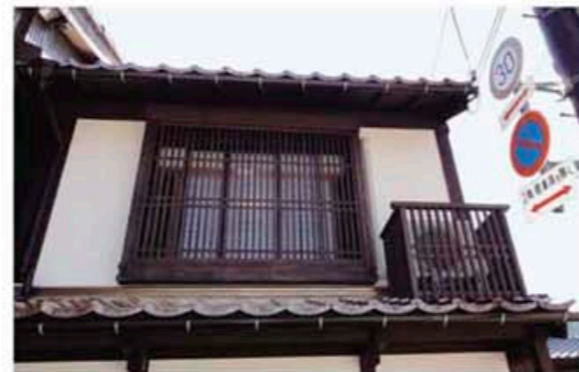
下屋の上に設けられた室外機を木製のカバーで修景した例。目隠しカバーを建具に設けられている木格子と同様の色彩・意匠とすることで外壁と調和したものとなっている。
