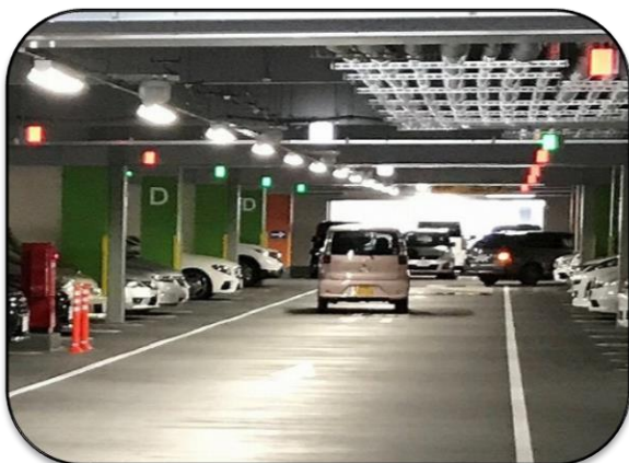
車両誘導システムによる空き駐車マスへの誘導
