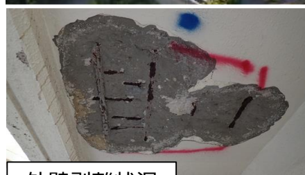
外壁剥離状況
