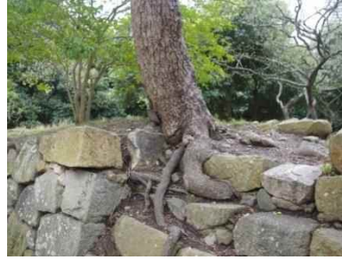
石垣に根が侵入している樹木
