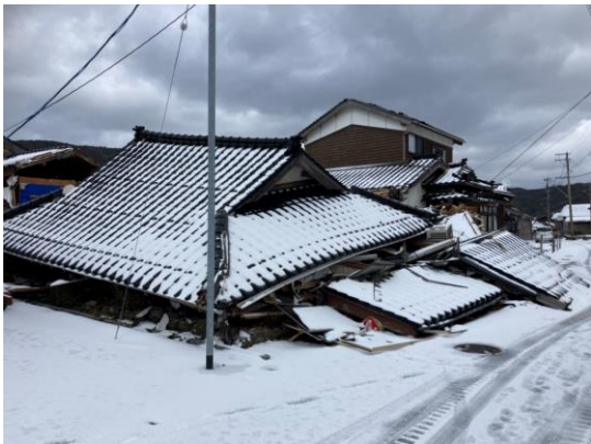
倒壊した木造建築物
