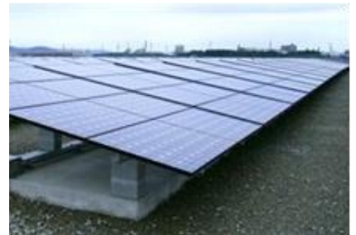
太陽光発電施設の設置例
