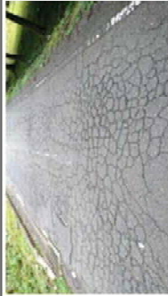
（舗装のひび割れ状況）
